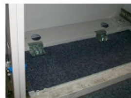
アンカーで固定したキャビネット
